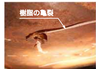
写真 - 4 樹脂の亀裂
