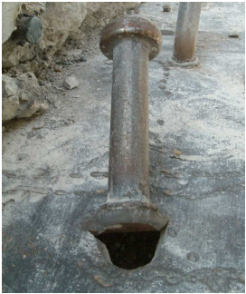
図 4 底鋼板がめくれたスタッド
