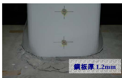
写真-2 NO2 終局状況
