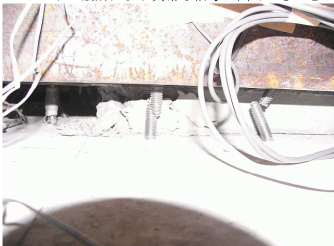
写真-1 アンカーボルトの破断(鷹取波 70%加振後)
