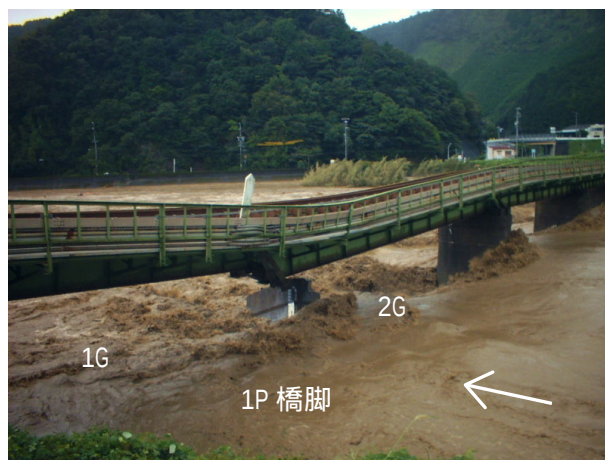
写真-1 被災時現場状況（1P橋脚流失前）
