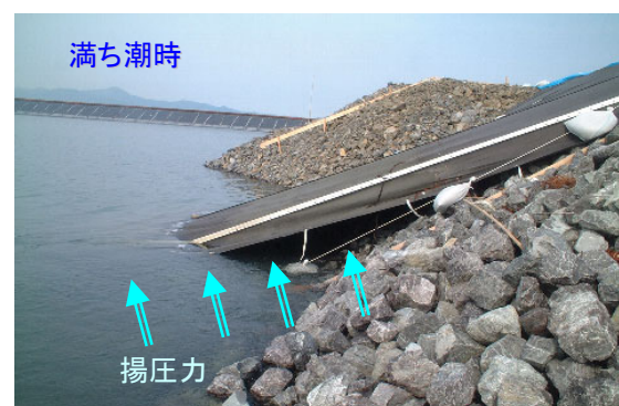
写真-2 揚圧力による防砂シートの捲れ上がり
