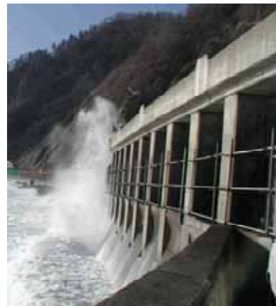
写真 - 1 落石覆道部の越波
