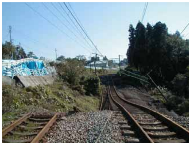
写真－1 上越線被災状況
