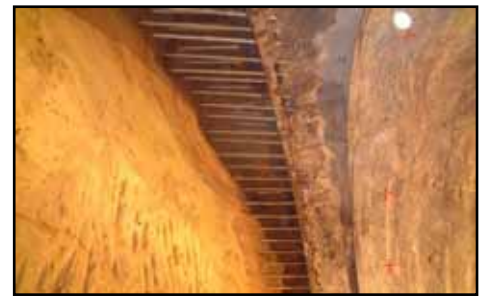
写真-3 天端抜落ち状況
