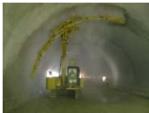
写真-1 噴霧養生装置
