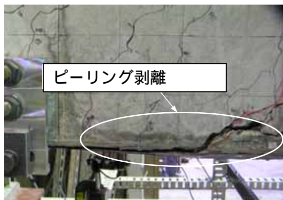
写真-1 ピーリング剥離 (C) の状況
