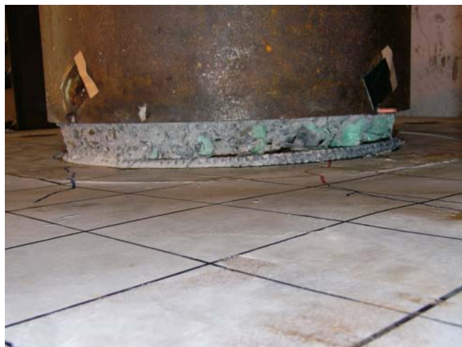
写真3 終局時の損傷状態（鋼管杭）
