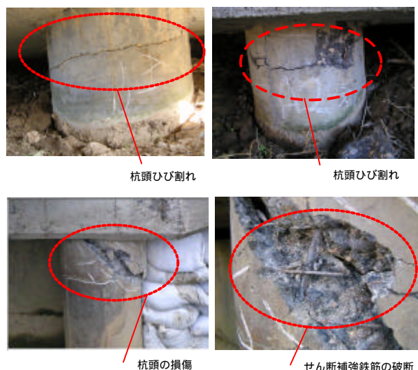
写真 - 1 被災状況
