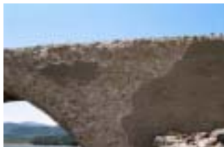
写真 3.1① 側壁の剥離状態
