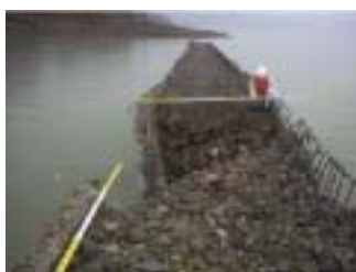
写真 3.1② 地震による側壁崩壊
