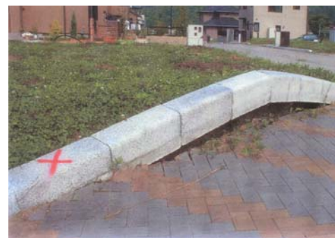
写真-1 コンクリート二次製品の膨張事例の一例
