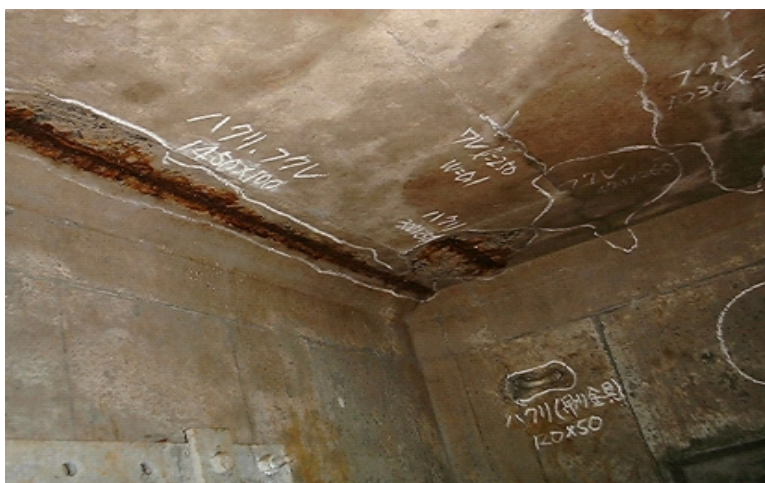
写真1. 塩害と中性化劣化
