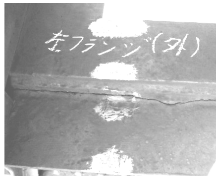
写真-1 溶接部亀裂状況
