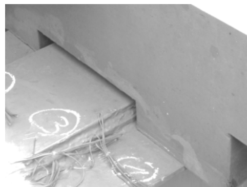
写真－2 マクラギ下面の隙間状況
