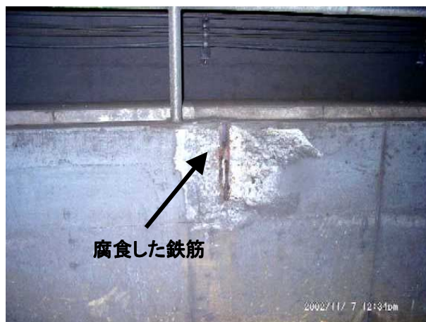
図3 腐食した鉄筋
