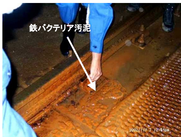
図2 排水溝がつまり湧水が溢れ出た例
