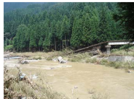
写真-4 第3鉄橋の被災状況
