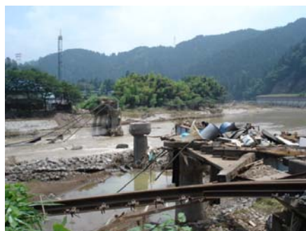
写真-1 第1鉄橋の被災状況
