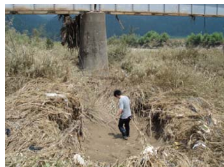
写真-7 第4鉄橋下流側の洗掘孔
