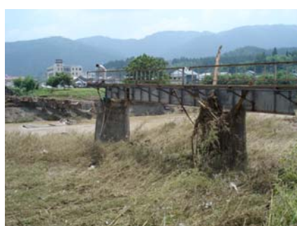
写真-6 第4鉄橋の被災状況
