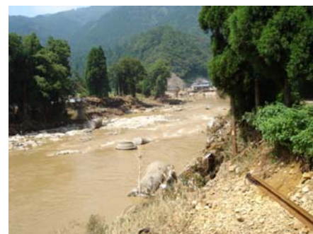
写真-10 第7鉄橋の被災状況
