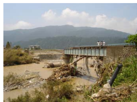
写真-8 第5鉄橋の被災状況
