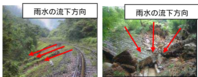
写真3 米坂線 45k930m 付近崩壊箇所
