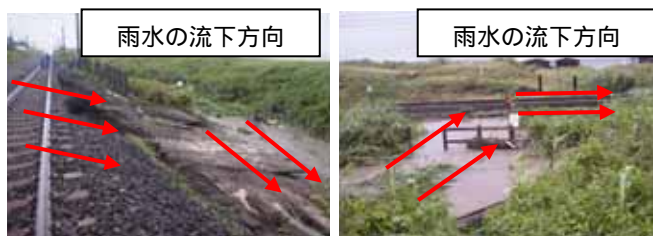
写真1 信越線 19k400m 付近崩壊箇所
