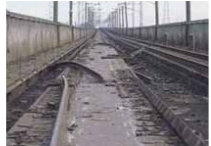
写真-1 脱線現場の被害状況
