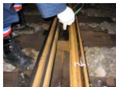
写真2 止め金具とトングレーの隙間測定
