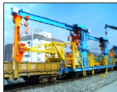
写真3 スラブ交換機（回送時）
