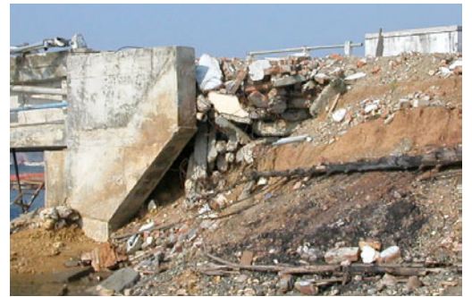
写真5 背面盛土流出後の応急復旧箇所
