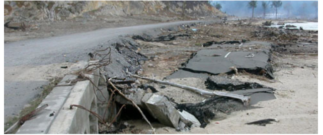
写真1 西海岸道路の道路および舗装損傷状況
