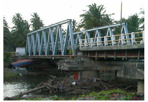
写真4 ほぼ無傷なトラス橋
