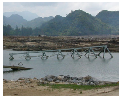
写真3 津波により流されたトラス
