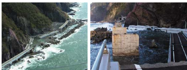
写真-1 大森大橋の被災状況
