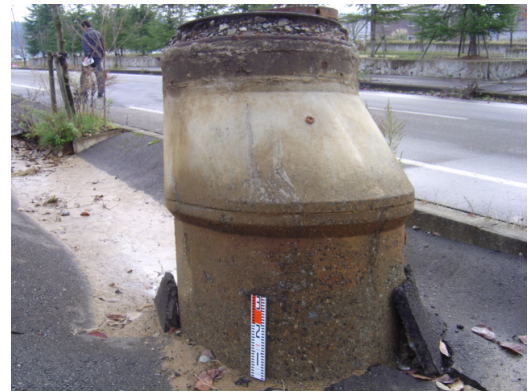
図-1 マンホール浮上り事例（新潟県中越地震）
