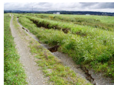
写真－1 右岸側の被災状況
