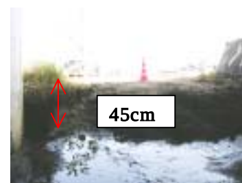
写真-2 小千谷 2 坑口部の沈下状況
