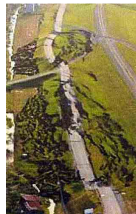
写真1 液状化によるⅢ型破壊（十勝川堤防） 1)
