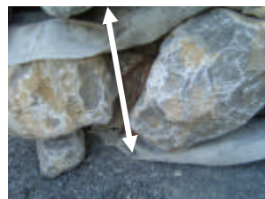
写真－3 折損状況
