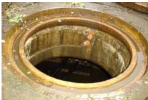
写真-1 マンホール首部の亀裂状況
