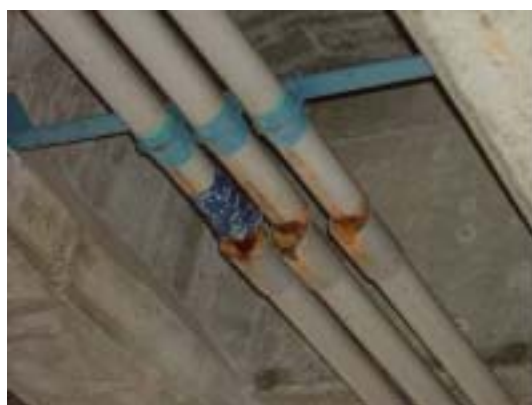
写真-3 橋梁添架管路伸縮継手の離脱状況
