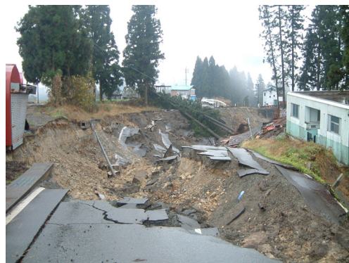
写真-1 地滑りにより流出した塩殿浄水場(小千谷市)
