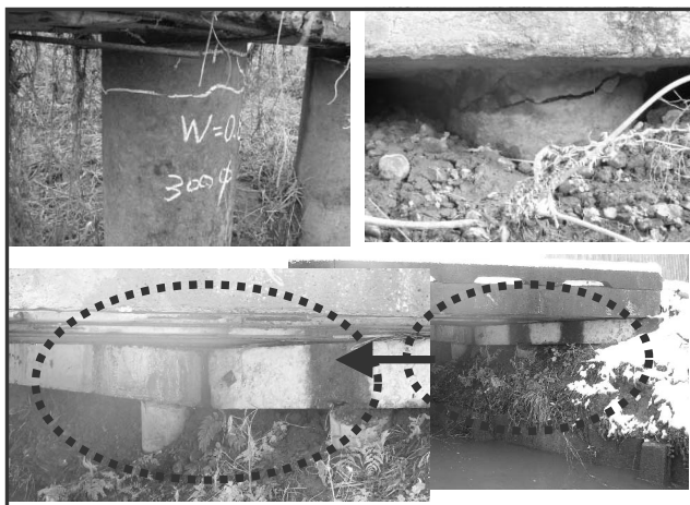
写真-2 パイルベントの損傷状況
