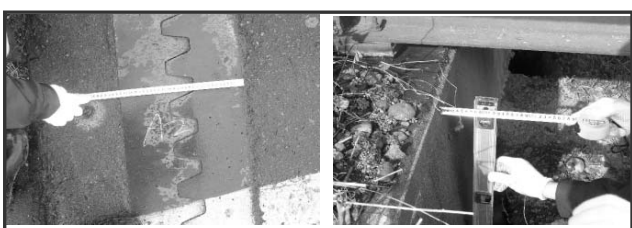
写真-4 遊間異常の状況
