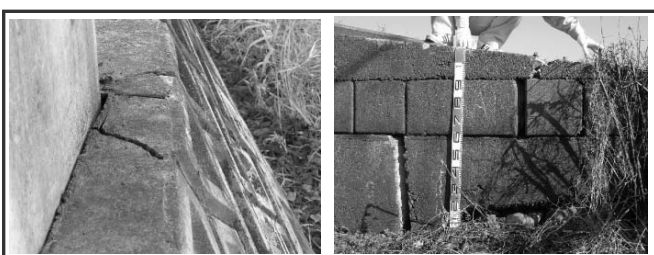
写真-6 護岸ブロックの損傷状況
