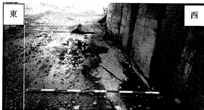
写真-1 木沢隧道における西側側壁の変形及び路盤の圧縮
