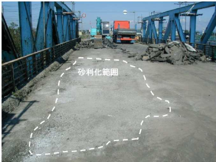
写真-2 床版上面の砂利化状況
