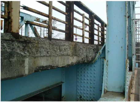
写真-3 地覆部の凍害による劣化
