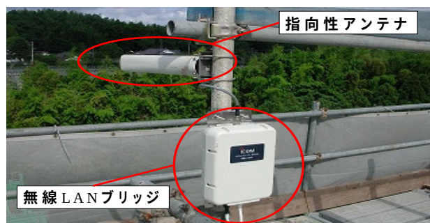
図-5 無線 LAN 設置状況
