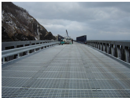
写真-2 オープングレーチング床版
