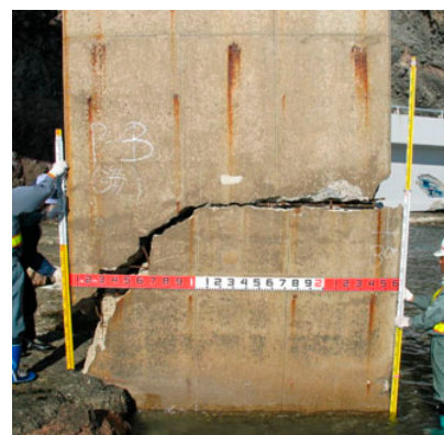
写真-3 P3 ひびわれ状況
