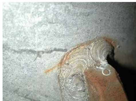
写真-1 まわし溶接部に発生した疲労き裂
