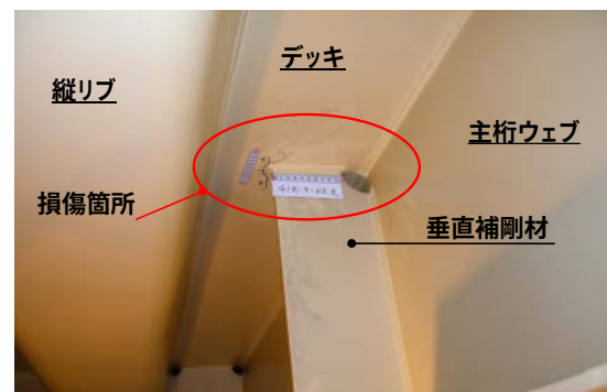
図-1 疲労亀裂発生箇所
