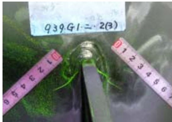
写真-2 垂直補剛材の疲労き裂（実橋）
