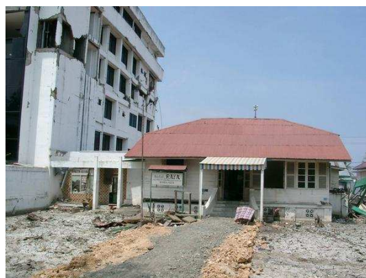
図-2 大きく被災した RC 構造物と、それに接する木造家屋（ホテル）
