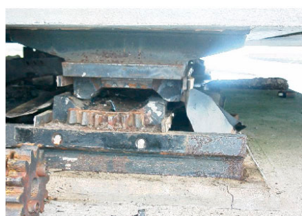
写真-2 ローラー沓の損傷
