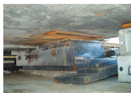
写真-3 ライナープレートの損傷
