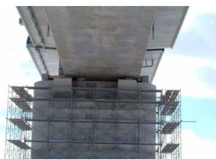
写真-1 桁端部のずれ
