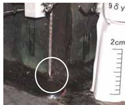
写真-1 き裂発生直後の様子
