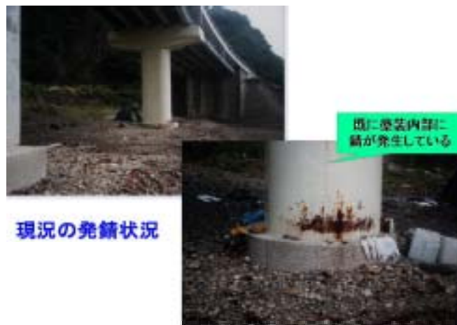
写真-1 河川橋脚における鋼板巻立工法の腐食度合
