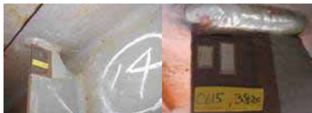
図3 センサ設置状況
