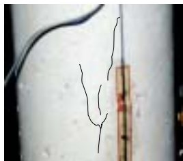
写真-1 ひび割れ (550 回载荷時)
