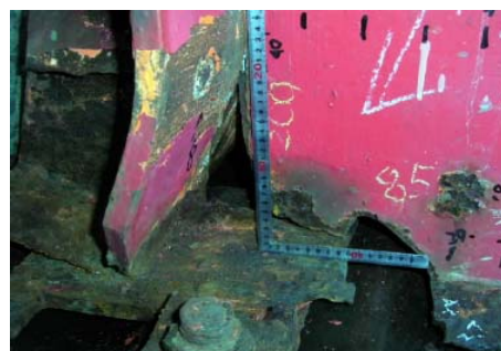
写真-1 腐食箇所が破断した例
