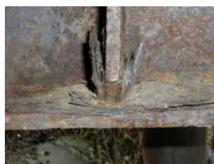
(d) H 橋の層状剥離
