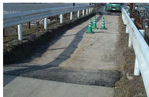
写真-4 床版陥没部状況
